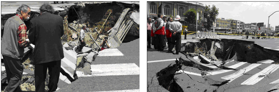
شکل ۷. فروریزی بخشی از یک قنات
